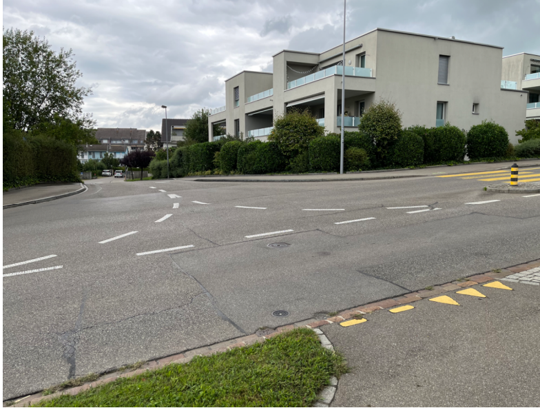
Abbildung 12 Zustand bei der Kreuzung Heiselstrasse West
