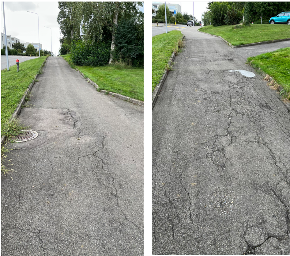
Abbildung 13 Schäden im Belag des Gehwegs westlich der Adlibogenstrasse
